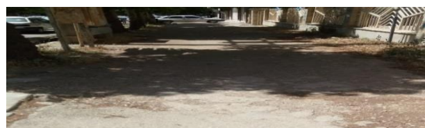
شکل شماره ۳: کفسازی نامناسب
